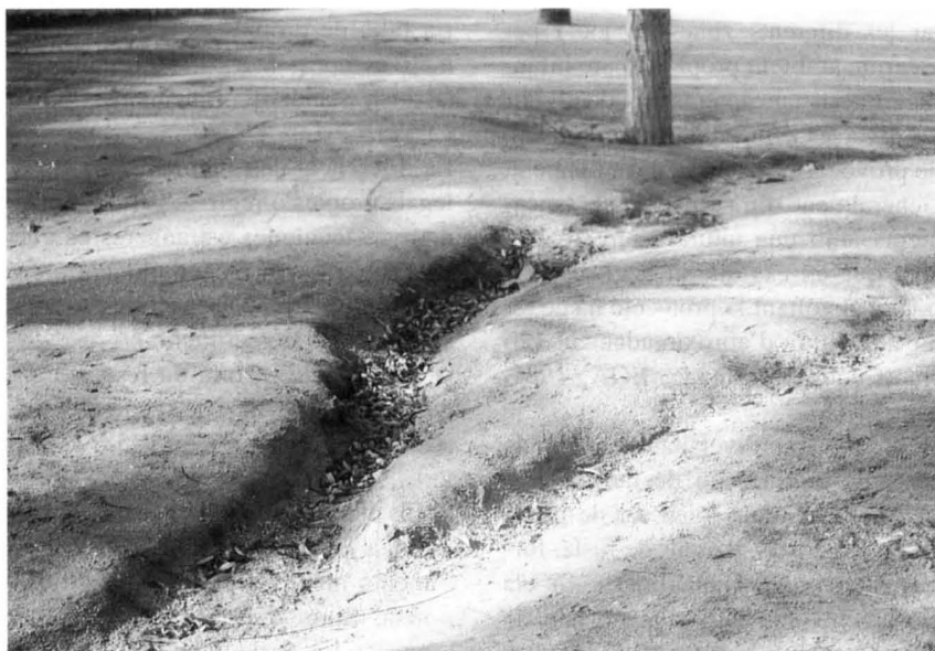
Les conseqüències d'un mal drenatge: es formen grans esquerdes per l'erosió del terra
